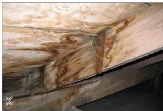
obr.č. 4: lokalita 2 – krokev plné vazby, v místě kotvení komínové lávky, poškozená dřevokaznými houbami; detail
