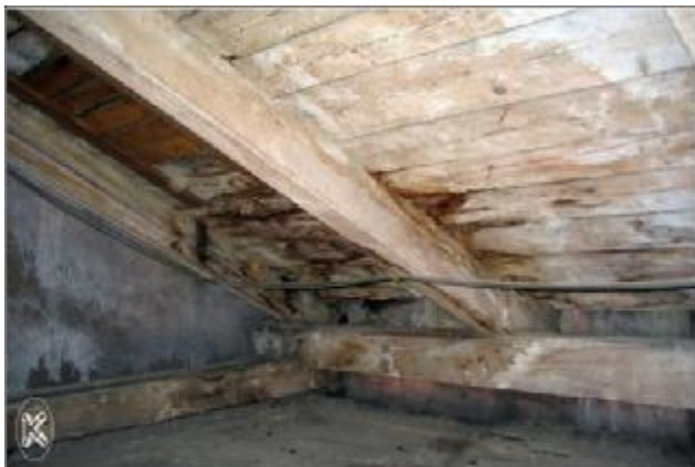
obr.č. 11: mapy, stopy po zatékání srážkové vody, na prknech plného bednění
