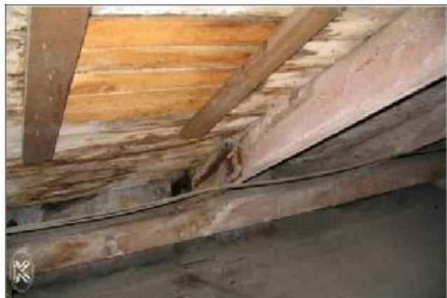
obr.č. 1: lokalita 1 – krokev, v místě kotvení komínové lávky, poškozená dřevokaznými houbami
