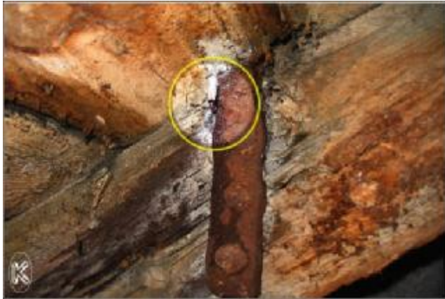
obr.č. 7: lokalita 3 – detail zatékání srážkové vody kolem kotvení komínové lávky
