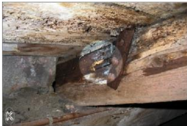
obr.č. 2: lokalita 1 – krokev, v místě kotvení komínové lávky, poškozená dřevokaznými houbami; detail
