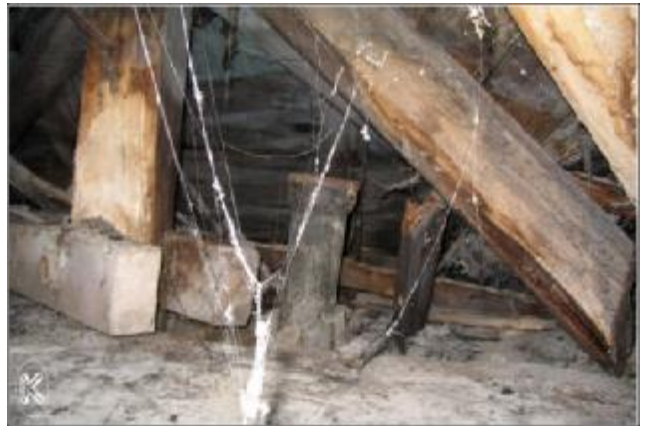
obr.č. 10: lokalita 4 – výrazné poškození střešního pláště a krokev uvolněná z tesařského spoje
