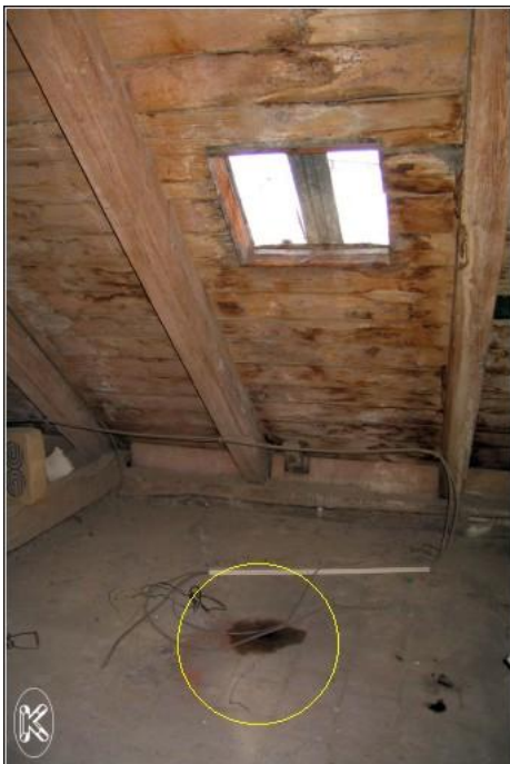
obr.č. 15: zatékání srážkové vody kolem re- vizního otvoru
