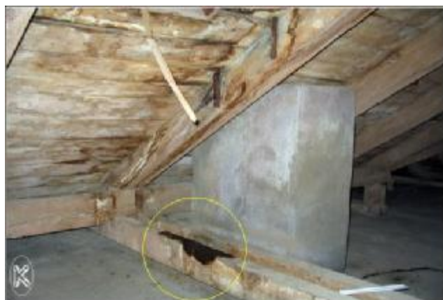
obr.č. 6: lokalita 3 – zvýšená vlhkost kleštiny v místě zatékání srážkové vody kolem kotvení komínové lávky
