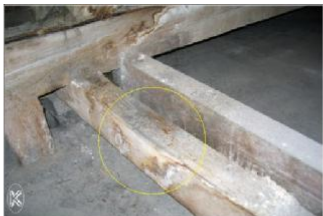
obr.č. 5: lokalita 2 – kleština plné vazby poškozená dřevokaznými houbami; detail
