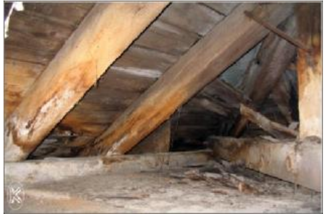
obr.č. 8: lokalita 4 – výrazné poškození střešního pláště
