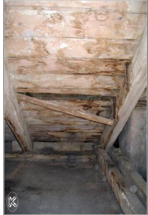
obr.č. 14: lokální poškození plného bednění
