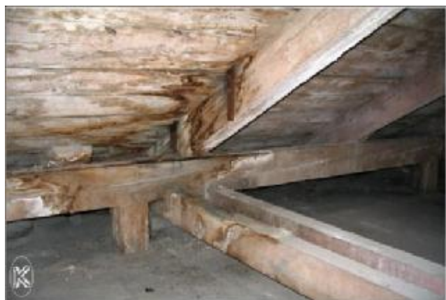
obr.č. 3: lokalita 2 – krokev plné vazby, v místě kotvení komínové lávky, a kleština poškozené dřevokaznými houbami
