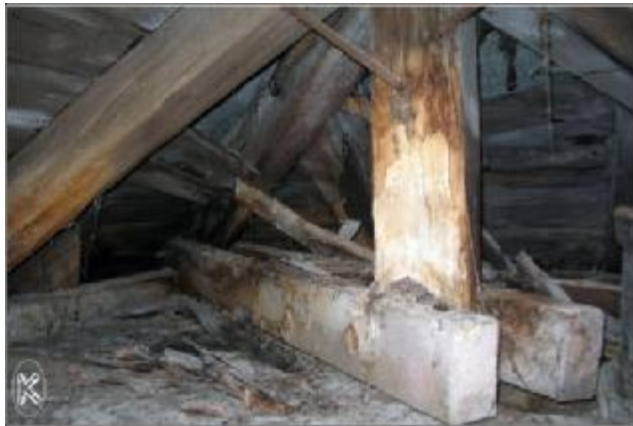
obr.č. 9: lokalita 4 – výrazné poškození střešního pláště
